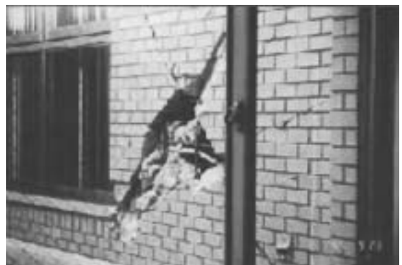
震災直後の病院の外壁
